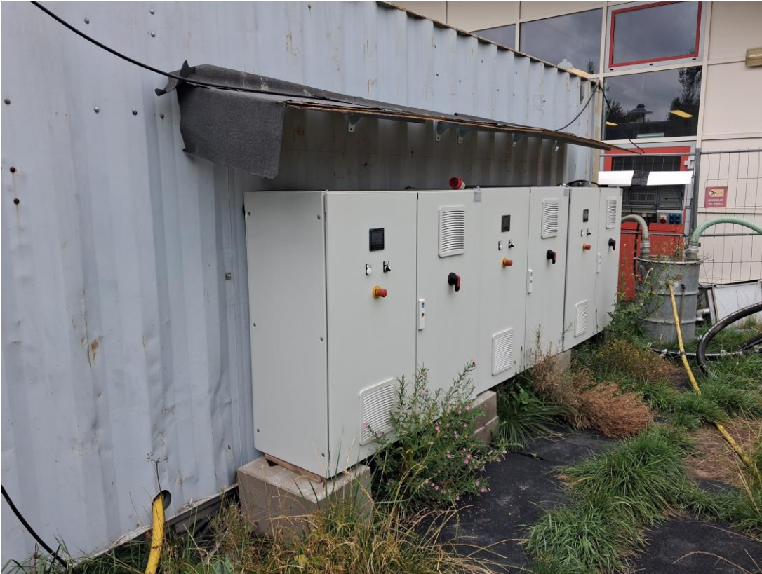
Steuereinheit der Thermik
