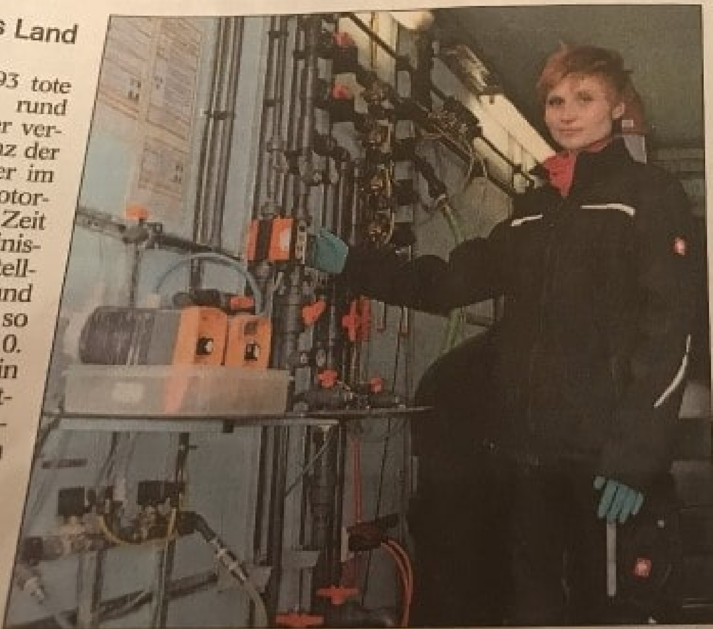
Projektleiterin Anja Wilken zeigt das Innenleben der PFC-Filteranlage „Bio-Kon“.
