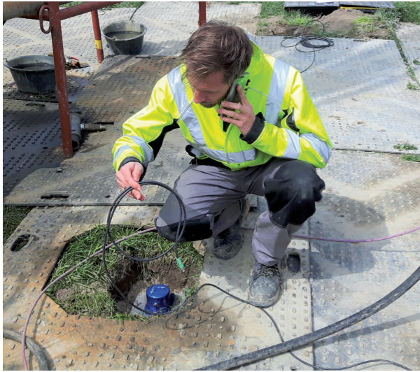
Kartierung der injizierten Feststoffschichten im Festgestein mittels Bodenneigungsmetertechnik
