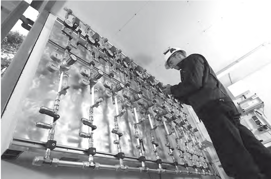
Blick in den Steuerungscontainer mit Bioxwand-Anlagentechnik
